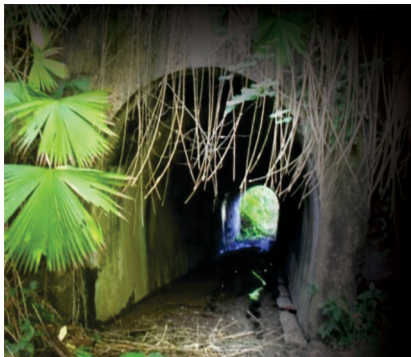
Túnel de montaña en la vía férrea del Gran Ferrocarril del Táchira entre San Félix y Uracá / 2016 Foto: Anderson Jaimes
