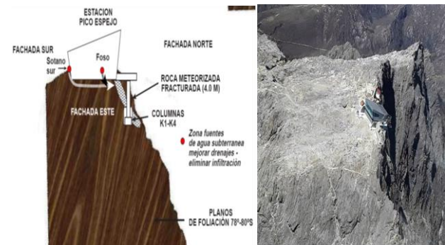
Figura 6. Se muestra la zona de fuente y manantiales de agua subterránea, planos de foliación dominantes y zonas de roca fracturada Las cuales afecta las fundaciones de la estación especialmente K1-K4. Fuente: Fotografía Meridaadventure, 2019.
