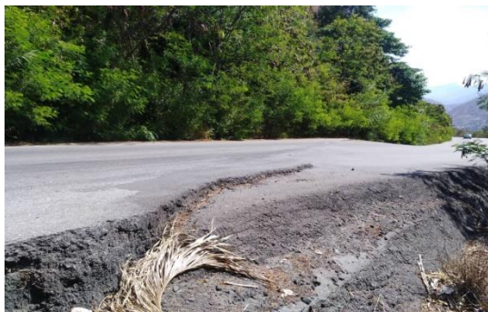
Figura 4. Deformación de la calzada de la carretera del sector La González.
