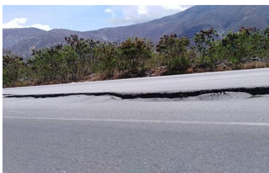
Figura 5. Deformación y falla de la calzada de la carretera del sector La González.
