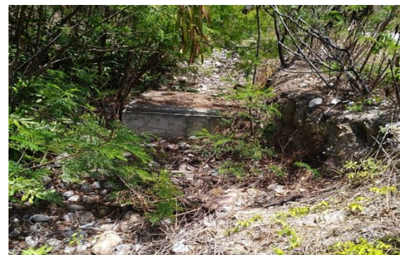
Figura 3. Subdrenaje de la sección transversal de carretera ubicada en el sector La González.
