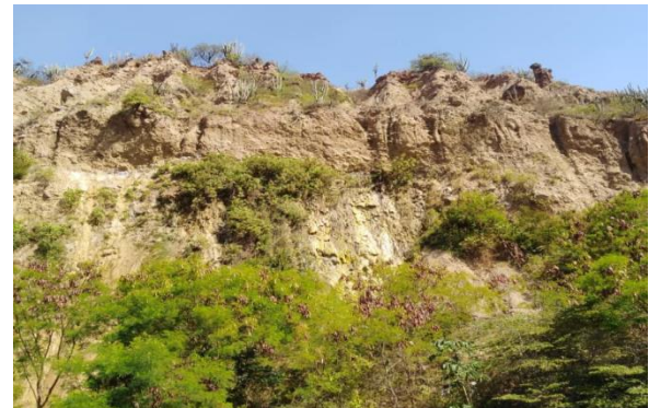
Figura 2. Emanación de agua del talud ubicado en el sector La González.
