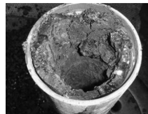
Fig. 1. Taponamiento de tubería ocasionado por la precipitación de los asfaltenos.
