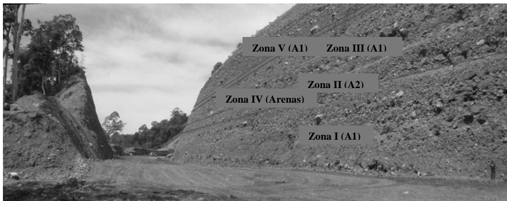
Fig. 4. Trinchera de la Autopista San Cristóbal – La Fría, progresivas 41+490 a 41+640. Obsérvese la zonificación realizada
