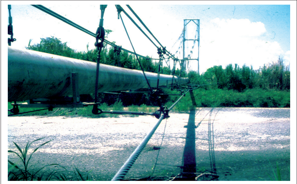
Figura 8. La socavación acelerada de los estribos del puente en la ribera derecha del río Guanare produjo deformaciones en la estructura; ella compite contra su estabilidad a corto plazo. La dirección del río transcurre de derecha a izquierda en la fotografía
